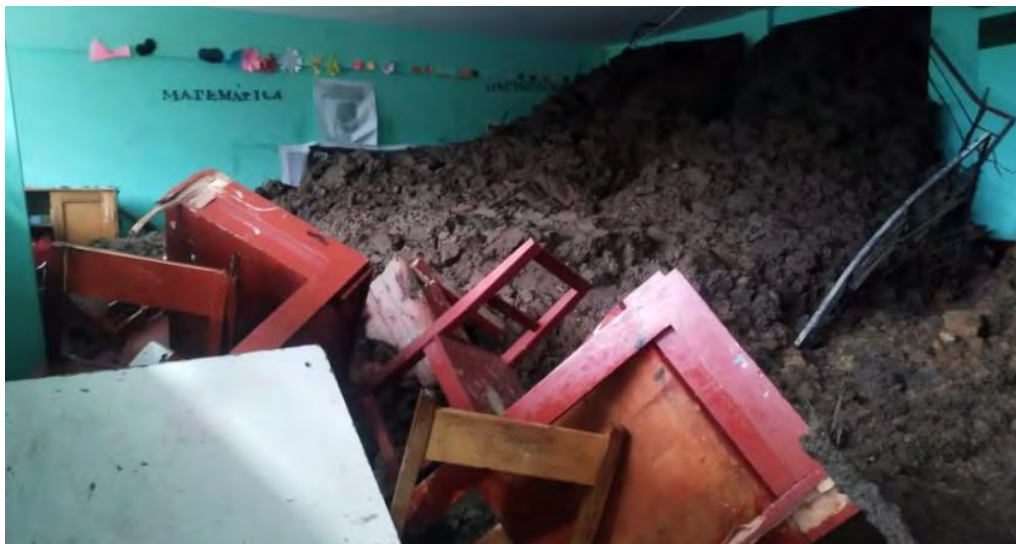
Figura 12. Institución educativa en Salcabamba afectada por el huaico del 17 de enero del 2026
